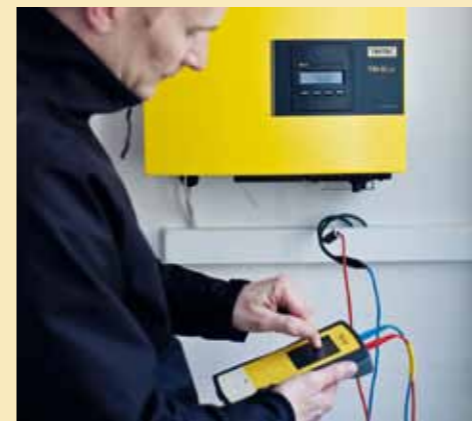
Mesurer la tension à vide et l'intensité de court circuit puis établir la courbe caractéristique intensité / tension de l'installation au moyen de l'analyseur TRI-KA.
